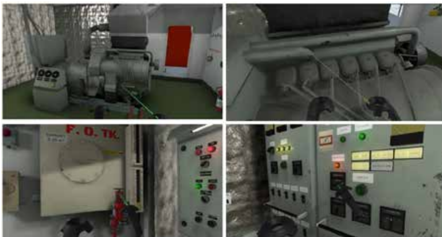
Рис. 3. Проходження процедури «Emergency generator routine maintenance» на симуляторі ВР
